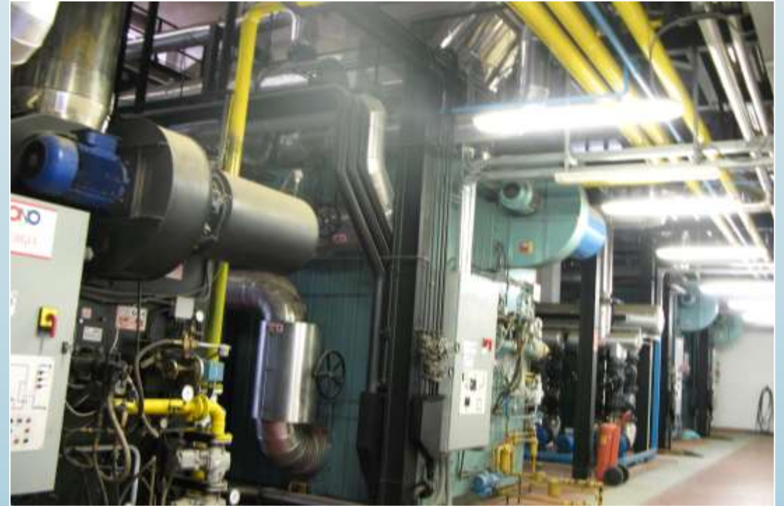
Centrale termica e generatori ad olio diatermico
