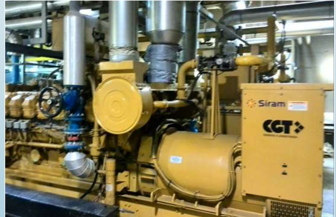
Centrale cogenerazione e gruppi di cogenerazione
