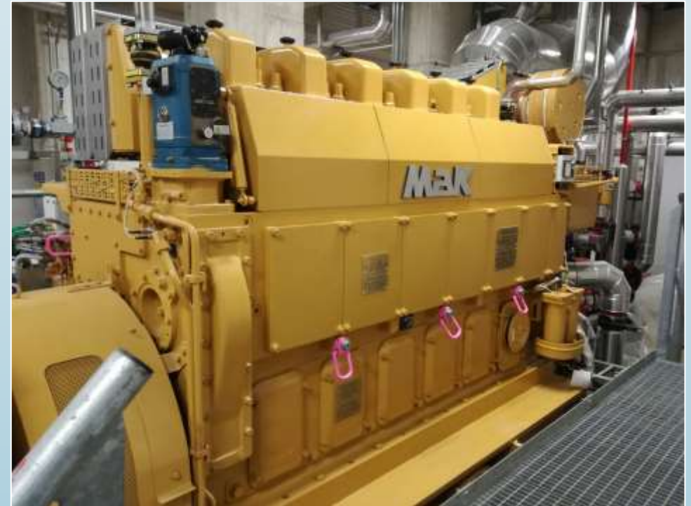
Nuova centrale cogenerazione e cogeneratore a oli vegetali
